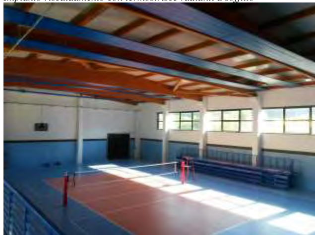
Impianto riscaldamento con termostrisce radianti a soffitto
