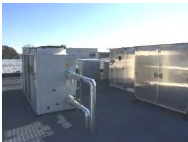
Impianto di climatizzazione e trattamento aria camere bianche
